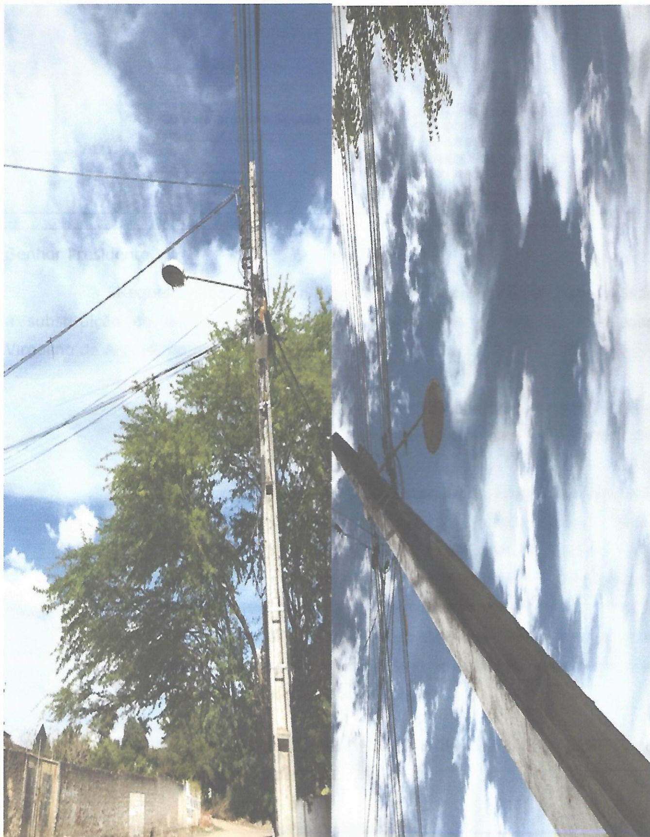
Imagem 1 e 2: lâmpadas queimadas, colocando em risco por quem transita aos arredores da EEEFM Ademar Veloso da Silveira.
